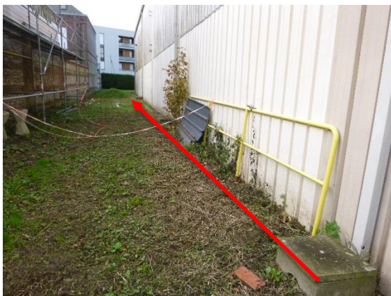
Collecteur \varnothing 100 mm des eaux de toitures du sud du gymnase vers la rue de la Gare
