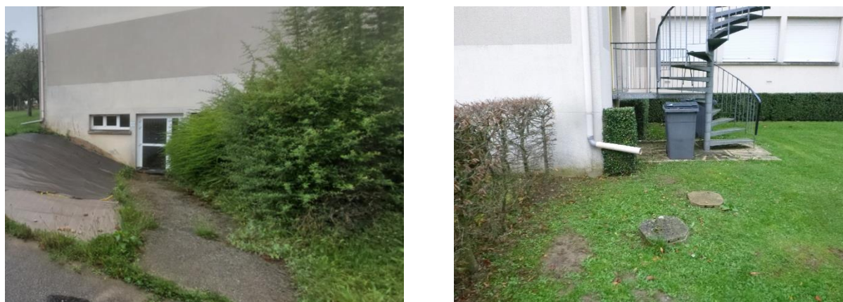
Entrée de la salle en sous-sol (inondée malgré un batardeau)
