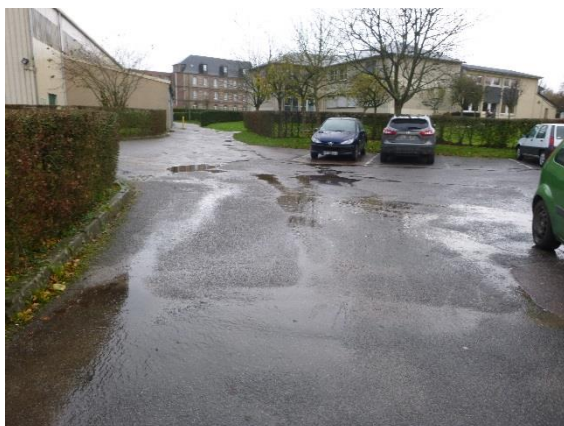
Écoulement par temps de pluies au niveau des accès au parking
