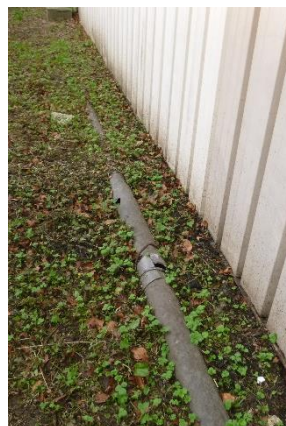
Fissure ouverte sur le \varnothing 100 mm et affleurement
